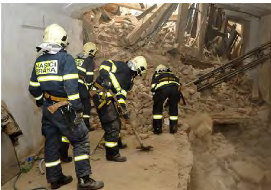
Zřícený dům v Soukenické ulici v Praze 1
