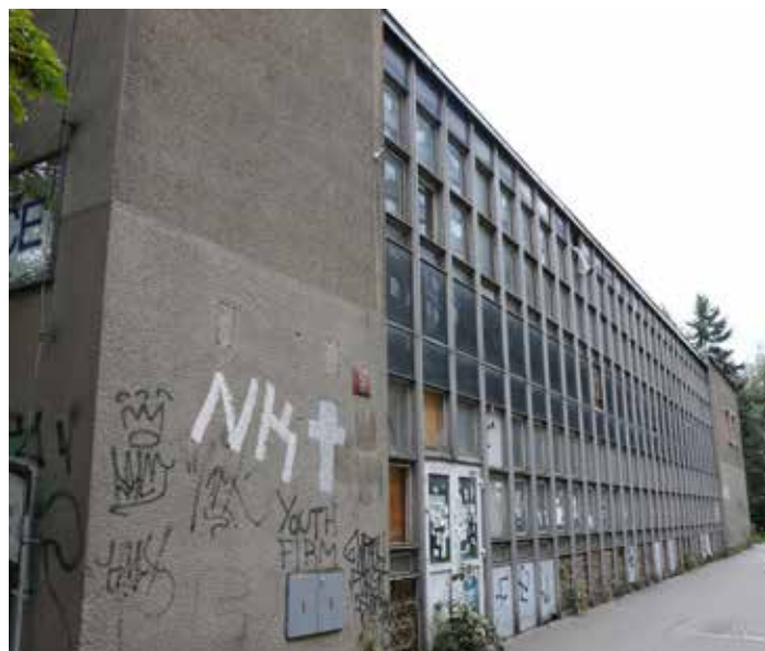
Objekt čp. 421 v Jablonecké ulici je dnes v neutěšeném stavu
